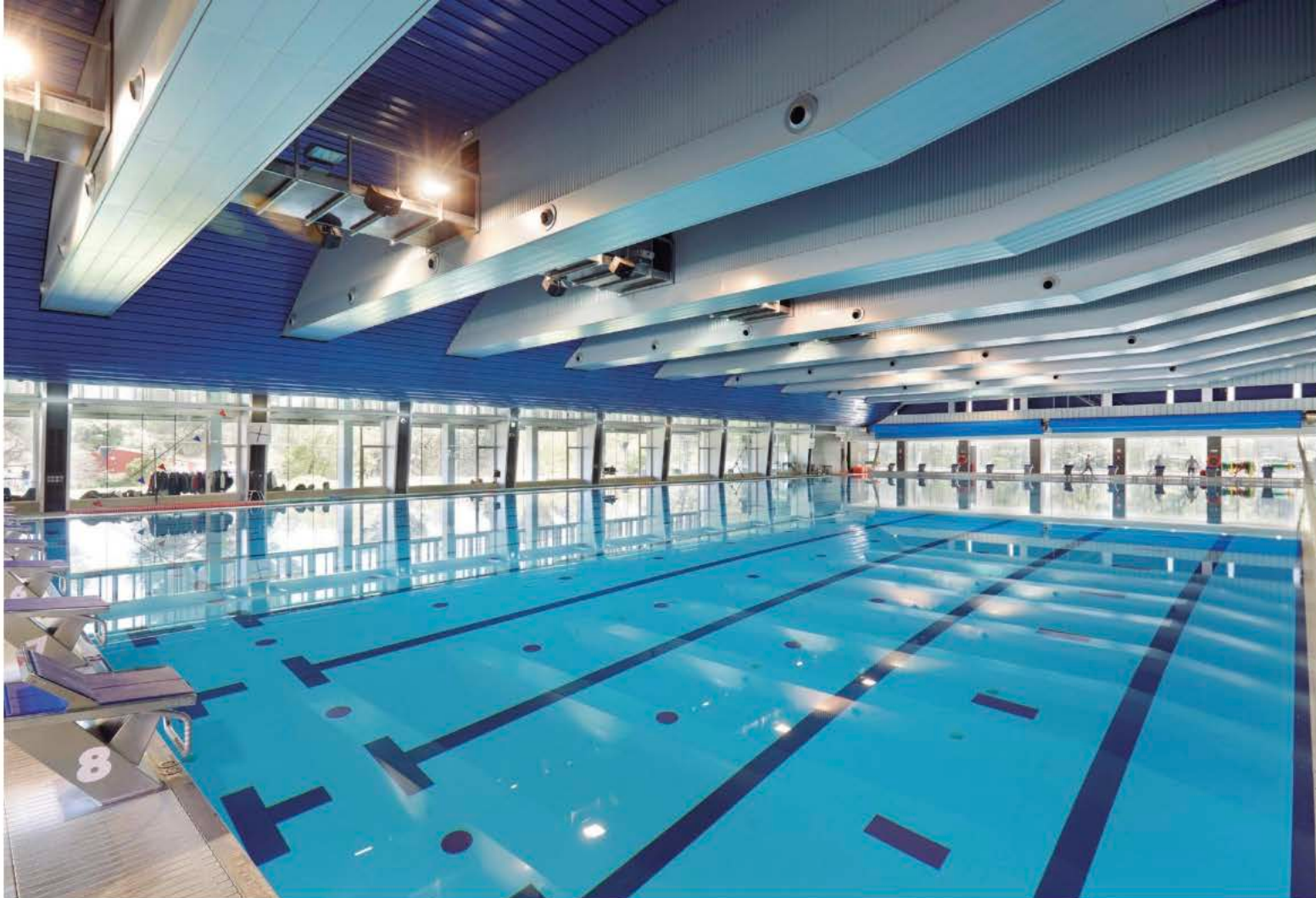
Centro Alto Rendimiento Sant Cugat, Spagna, realizzazione Fluidra, a cui si possono affiancare vasche divertimento per la collettività con massima attenzione all'efficienza energetica
